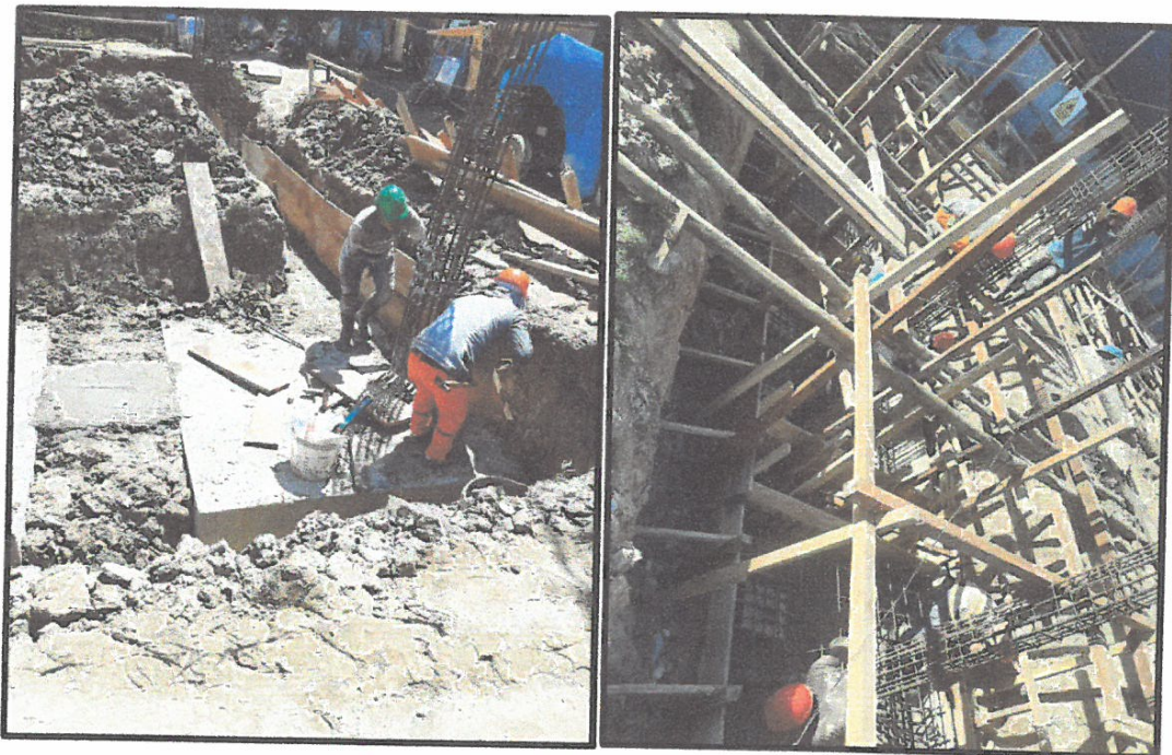
TRABAJOS DE ENCOFRADOS DE VIGAS DE CONEXIÓN Y HABILITACION DE ACERO Y COLOCADO DE LAS MISMAS EN ZAPATAS.
